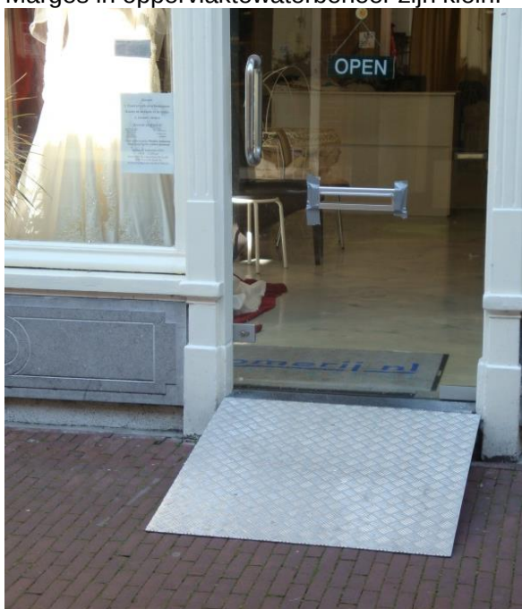
Bodemdaling: straat en winkelvloer hebben niet meer dezelfde hoogte.
