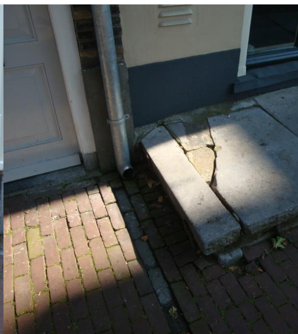
Twee huizen en hun voordeuren. Voordeur van het rechterhuis is hoger dan die van het linkerhuis. Regenwaterafvoer via de straat.
